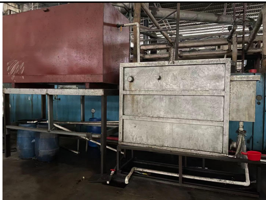
喷淋废水油水分离设施
